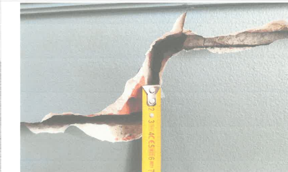
Fot. 08. Piętro I, ściana szczytowa od strony wykopu – pomiar szerokości pęknięć.
