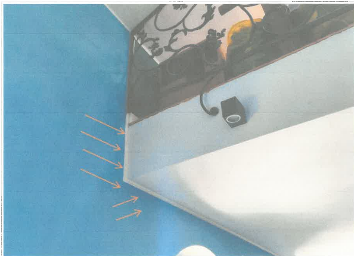
Ryc. 08. Strop nad drugim piętrzem. Zarysowanie w miejscu oparcia stropu na ścianie.
