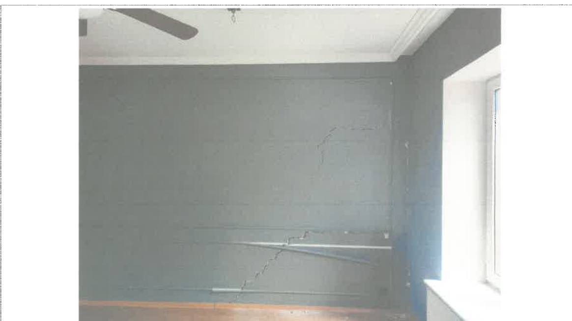
Fot. 08. Piętro I, ściana szczytowa od strony wykopu i naroże w osiach 3/B – widok ogólny. Widoczne pęknięcia i zarysowania ściany.
