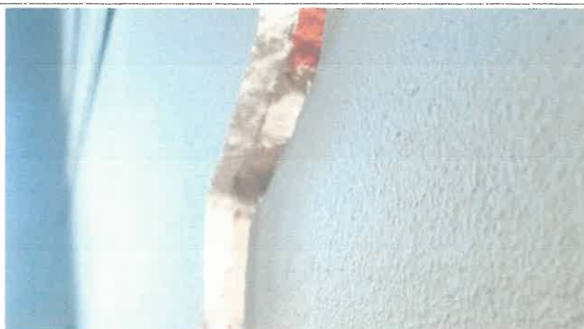
Fot. 09. Piętro I, ściana szczytowa od strony wykopu – przesunięcie poziome ściany na pęknięciu skośnym o ok. 15-20 mm.
