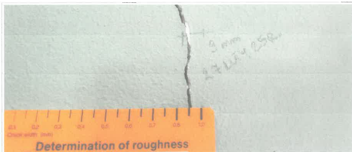
Fot. 12. Piętro II, ściana podłużna przy narożu w osiach 3/B – pęknięcie przy nadprożu okiennym.
