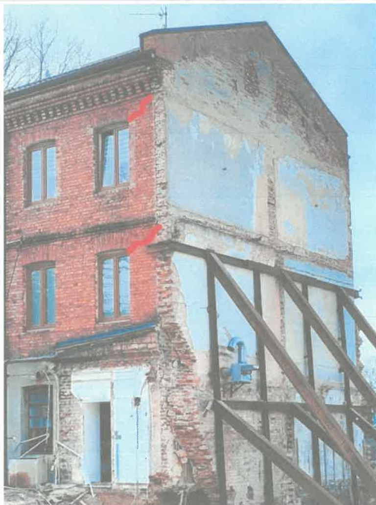
Ryc. 05. Lokalizacja zarysowań i pęknięć ściany nośnej w osi „3”.
