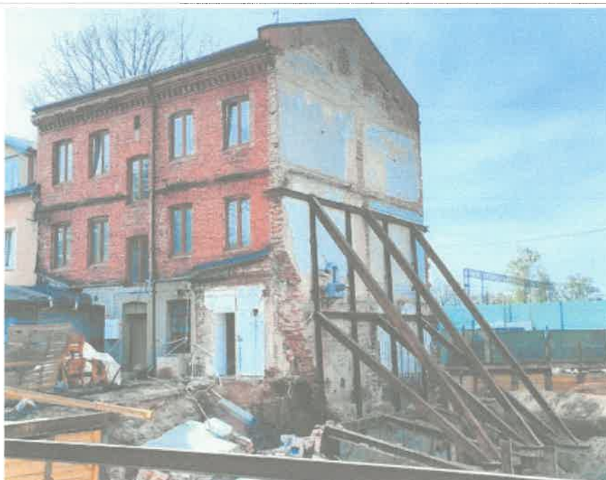
Fot. 02. Ściana szczytowa od strony inwestycji Warszawska 23 – widok ogólny kilka godzin po katastrofie.
