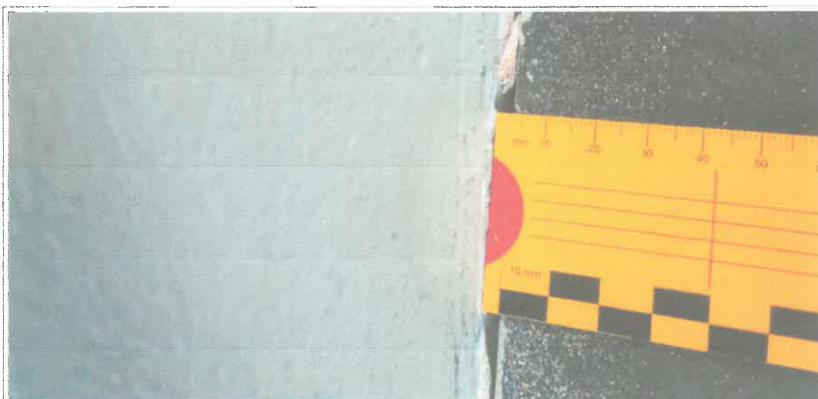
Fot. 13. Piętro II, styk warstw posadzkowych ze ścianą szczytową od strony działki Warszawska 23. Widoczna szczelina świadczy o odchyleniu ściany od pionu.
