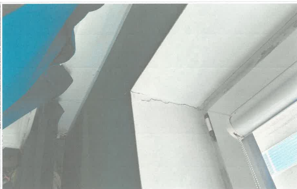
Fot. 11. Piętro II, ściana podłużna przy narożu w osiach 3/B – pęknięcie przy nadprożu okiennym.
