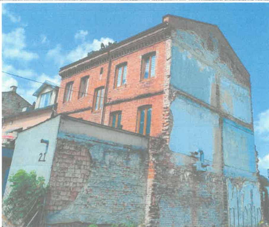
Fot. 01. Ściana szczytowa od strony inwestycji Warszawska 23 – widok ogólny przed katastrofą.
