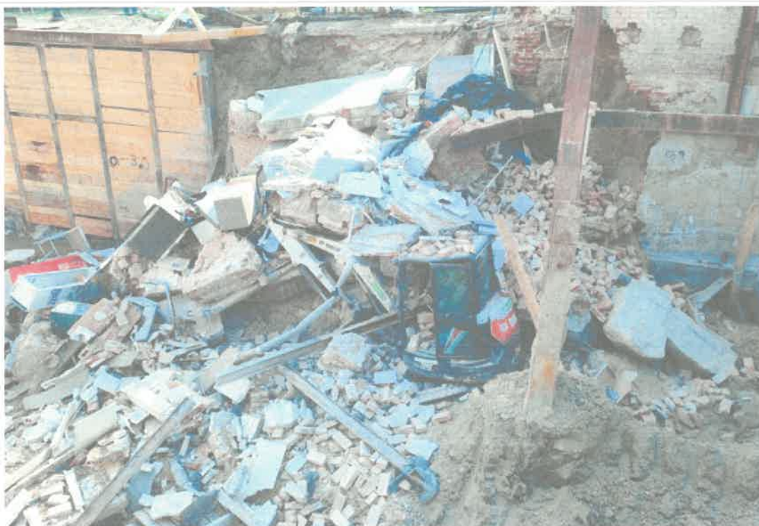
Fot. 03. Zawalona przybudówka na kilka godzin po katastrofie. Brak pali i rozpór na długości przybudówki. W wykopie widoczna koparka pozwalająca oszacować głębokość wykopu na ok. 4,0m.
