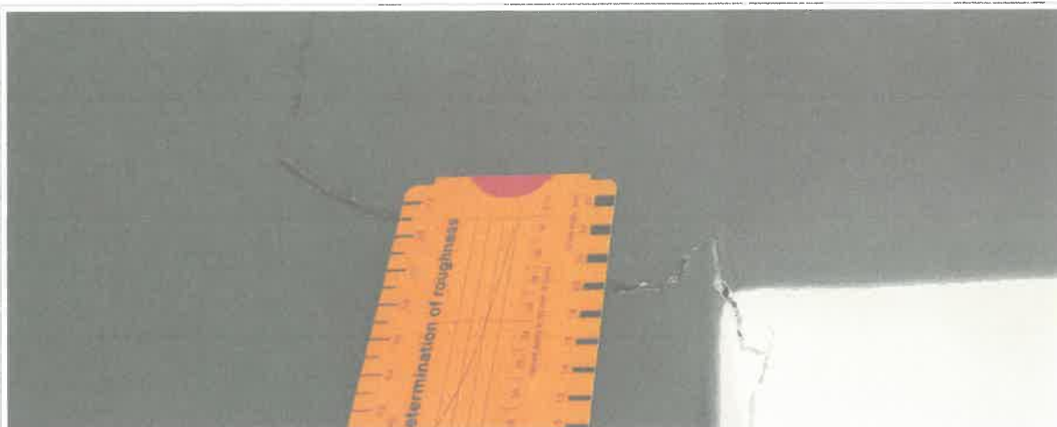
Fot. 10. Piętro I, ściana podłużna przy narożu w osiach 3/B – pęknięcie przy nadprożu okiennym.
