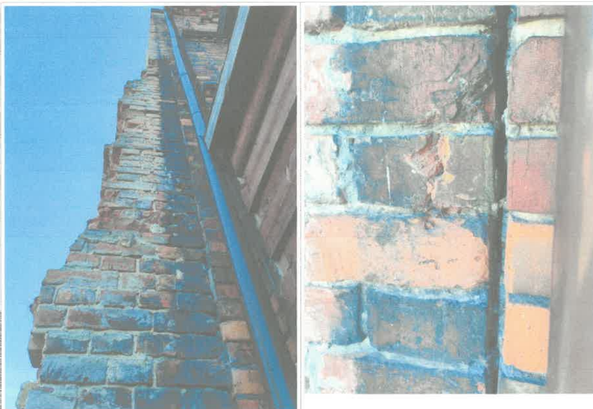
Fot. 07. Ściana szczytowa na styku z elewacją od strony torów kolejowych. Widoczny brak przewiązania muru do wysokości stropu nad I piętrem.
