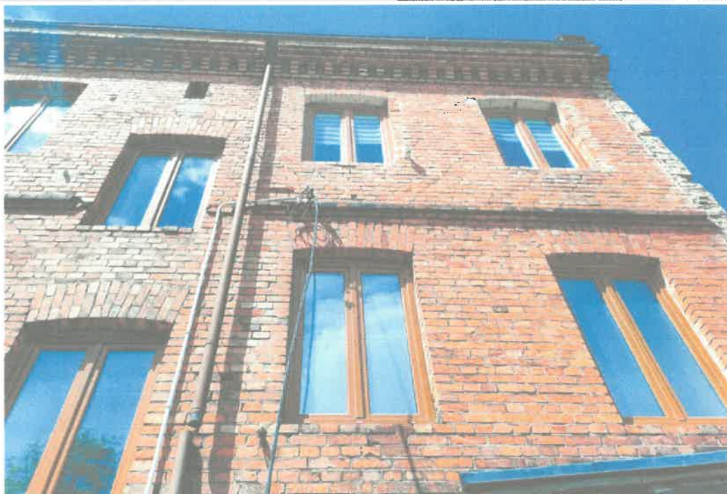
Fot. 05. Elewacja od strony ul. Warszawskiej – widok ogólny po katastrofie. Brak widocznych uszkodzeń powyżej poziomu terenu.
