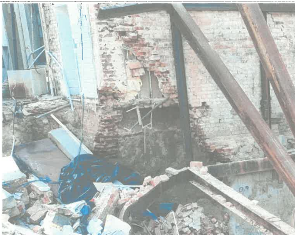
Fot. 06. Naroże budynku przy zawalonej przybudówce. Widoczne ubytki fundamentów ściany podłużnej oraz fundamentów i fragmentów ściany szczytowej.
